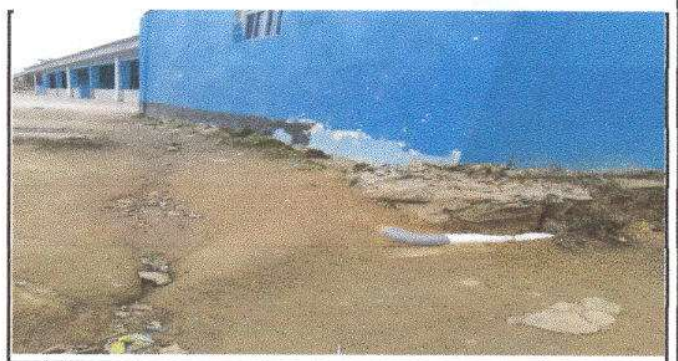
Foto 12: Introduucción de 33 metros de drenaje a fosa de baños por pila instalada.
