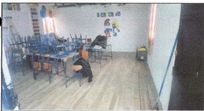
Foto 11: Aplicación de pintura color blanco en paredes internas del aula de párvulos.
