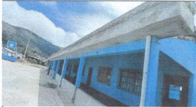
Foto1: Mantenimiento a estructura de soporte de metal, fundición de marquesina en módulo I, primaria
